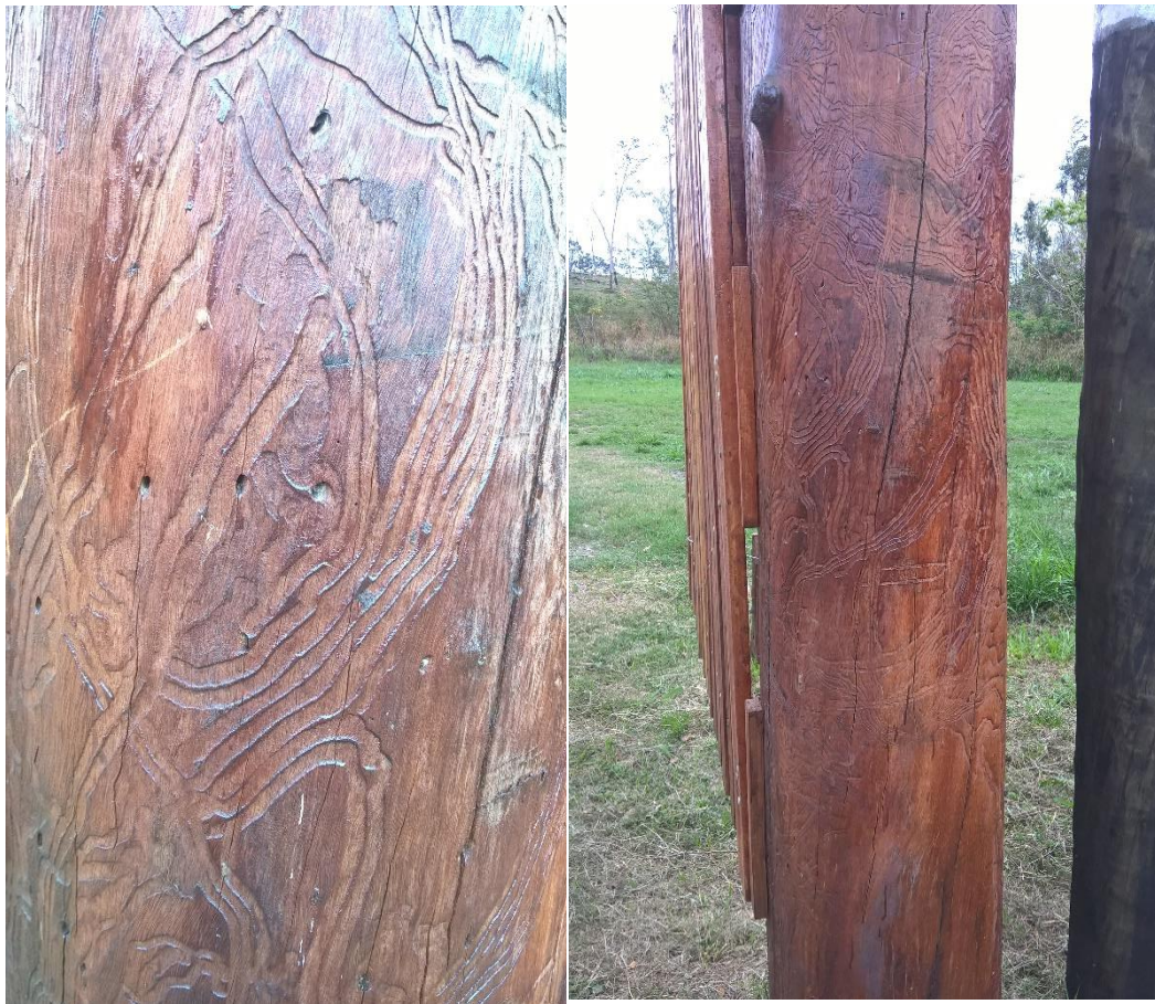
Figura 13 - Porteira construída com moirão de eucalipto atacado por insetos xilófagos devidamente tratada. IF, UFRRJ, 2017.
