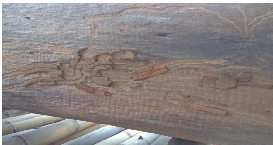
Figura 7- Tora de Eucalyptus spp. danificadas por insetos deterioradores Phoracantha spp. IF, UFRRJ, 2017.
