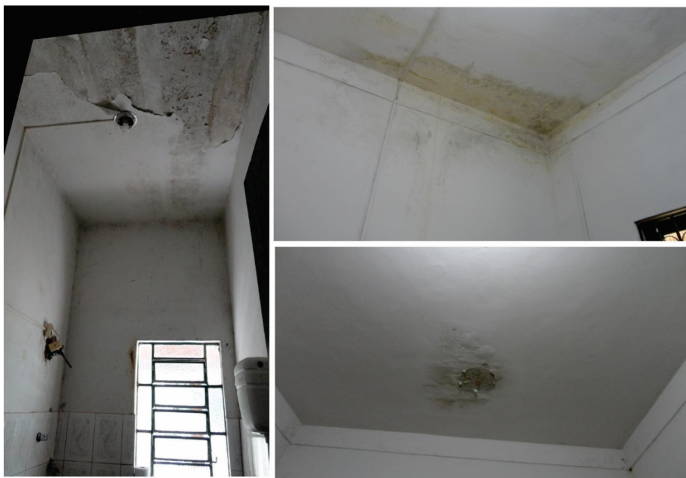
Figura 71: Sede administrativa da Rebio do Tinguá, problemas no estado de conservação da edificação. Fonte: Acervo AUTOR (2020)
